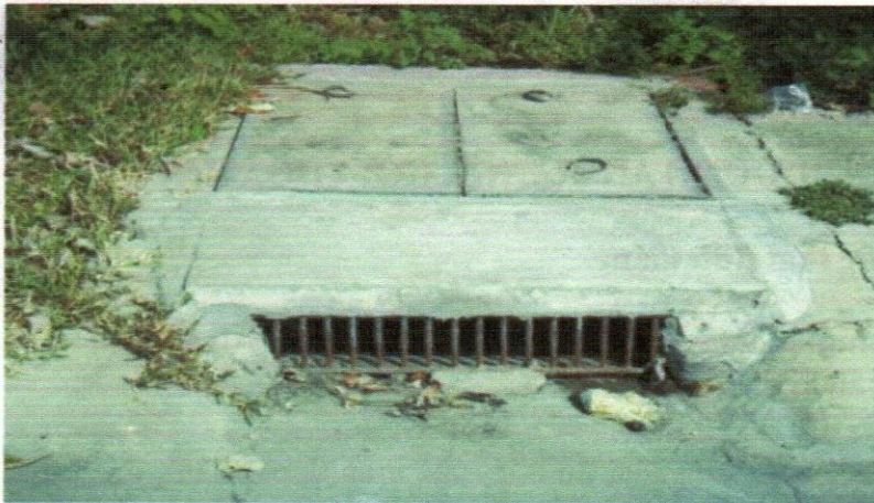
Hình 2.3 Hố ga thu nước mưa.
